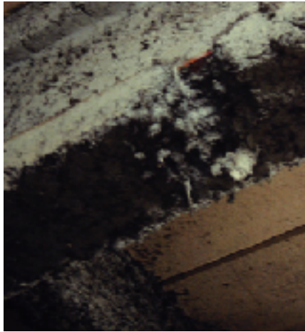
鉄骨に吹き付けているアスベスト
