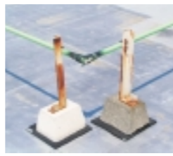
屋上架空配管
