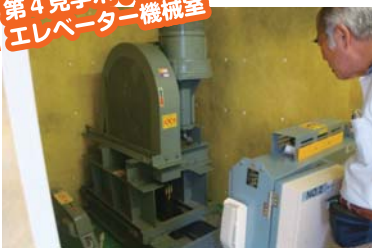
エレベーターのロープを巻き上げる機械です。 エレベーターがいきなり動き出すと大変危険なので、要注意!
