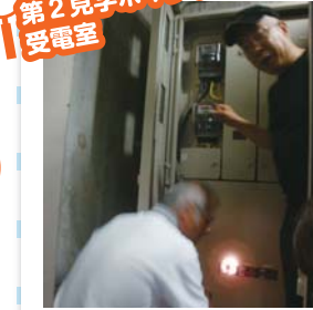
続いて、1階にある受電室です。電力会社からの電気を引き込む盤がここにあります。
