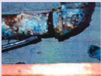
【例1】ねじ部腐食による穴あき
