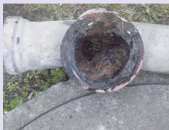
【例3】铸铁管の内部腐食・閉塞
