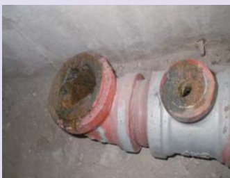
【例4】管内面に付着した汚れ・閉塞
